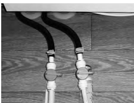
Ventile in geschlossener Position
