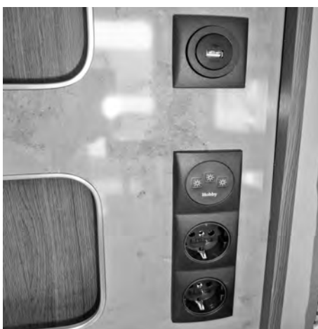
Steckdosen im Innenraum
