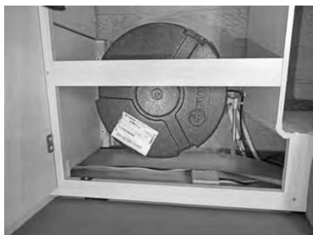
Boiler mit Ablassventil
