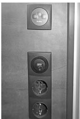
Steckdosen im Innenraum
