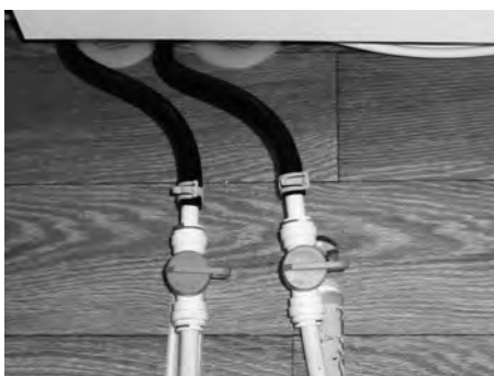
Ventile in geschlossener Position
